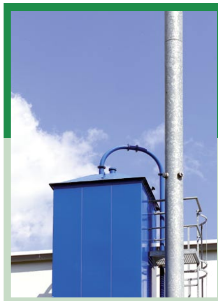
Plate-forme de maintenance
